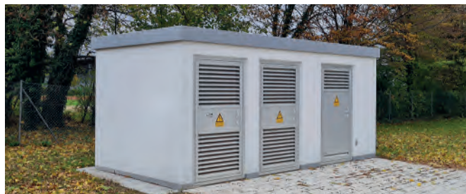
Beispiel: Begehbare Trafostation
